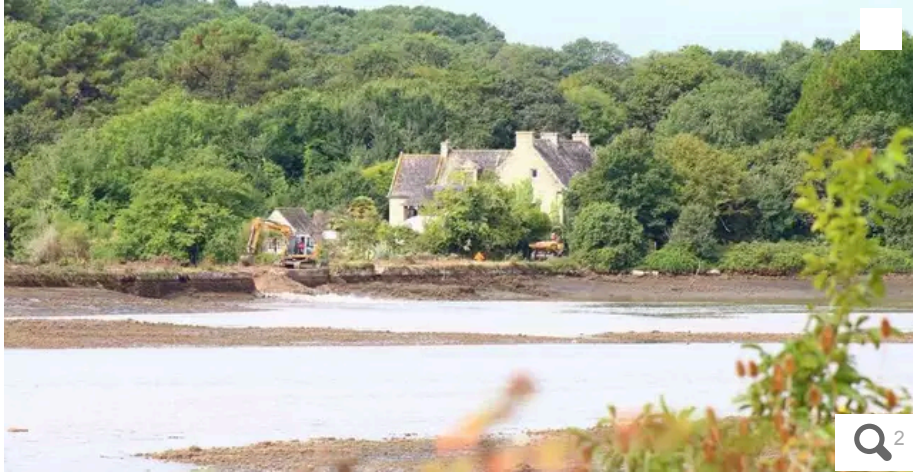
Le niveau de l'étang du Ter restera bas jusqu'à vendredi pour permettre des travaux de remise en état de la digue du Symbole, à côté de la discothèque. © Ouest-France
