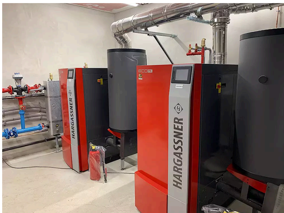
Chaufferie bois granulés pour la Mairie de Bubry (56) © ID Energies Bio
