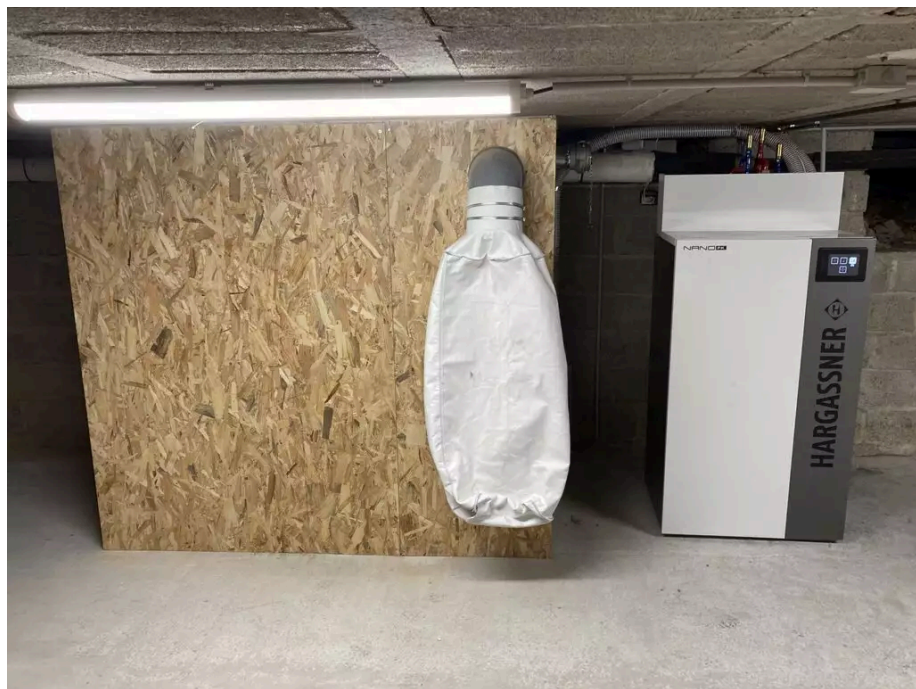
Chaudière granulés de 15 kw pour la production de chauffage à Meslan (56) © ID Energies Bio
