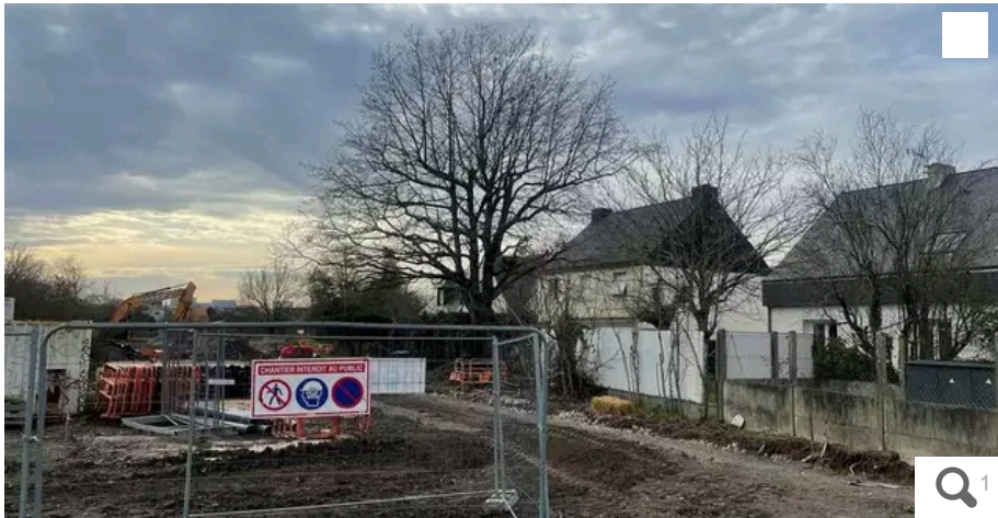
Les travaux de viabilisation ont commencé. Mais la première phase de construction de logements ne démarrera que cet été. © Ouest-France
