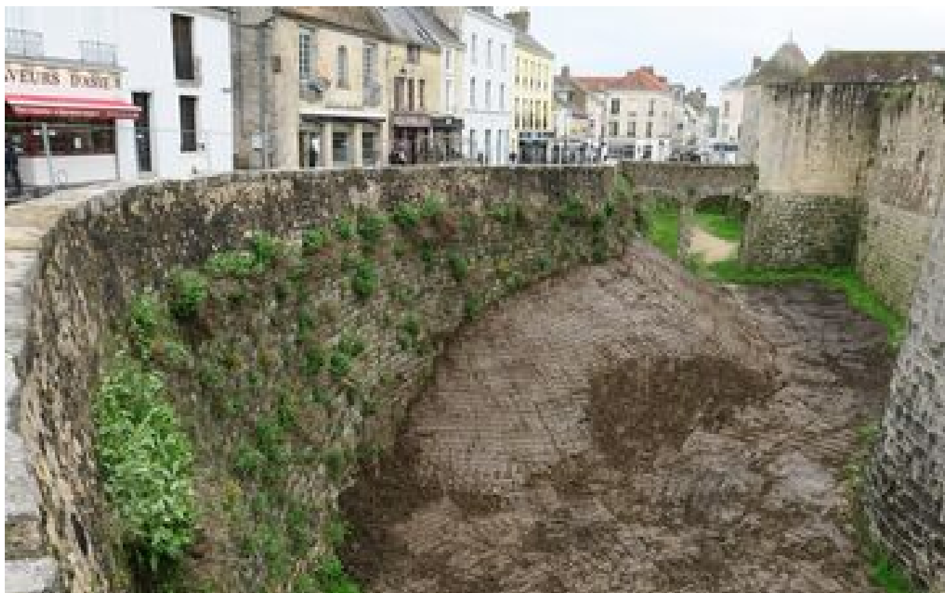
Après la rupture de canalisation d'eau, le mur du château de Dourdan a été consolidé
