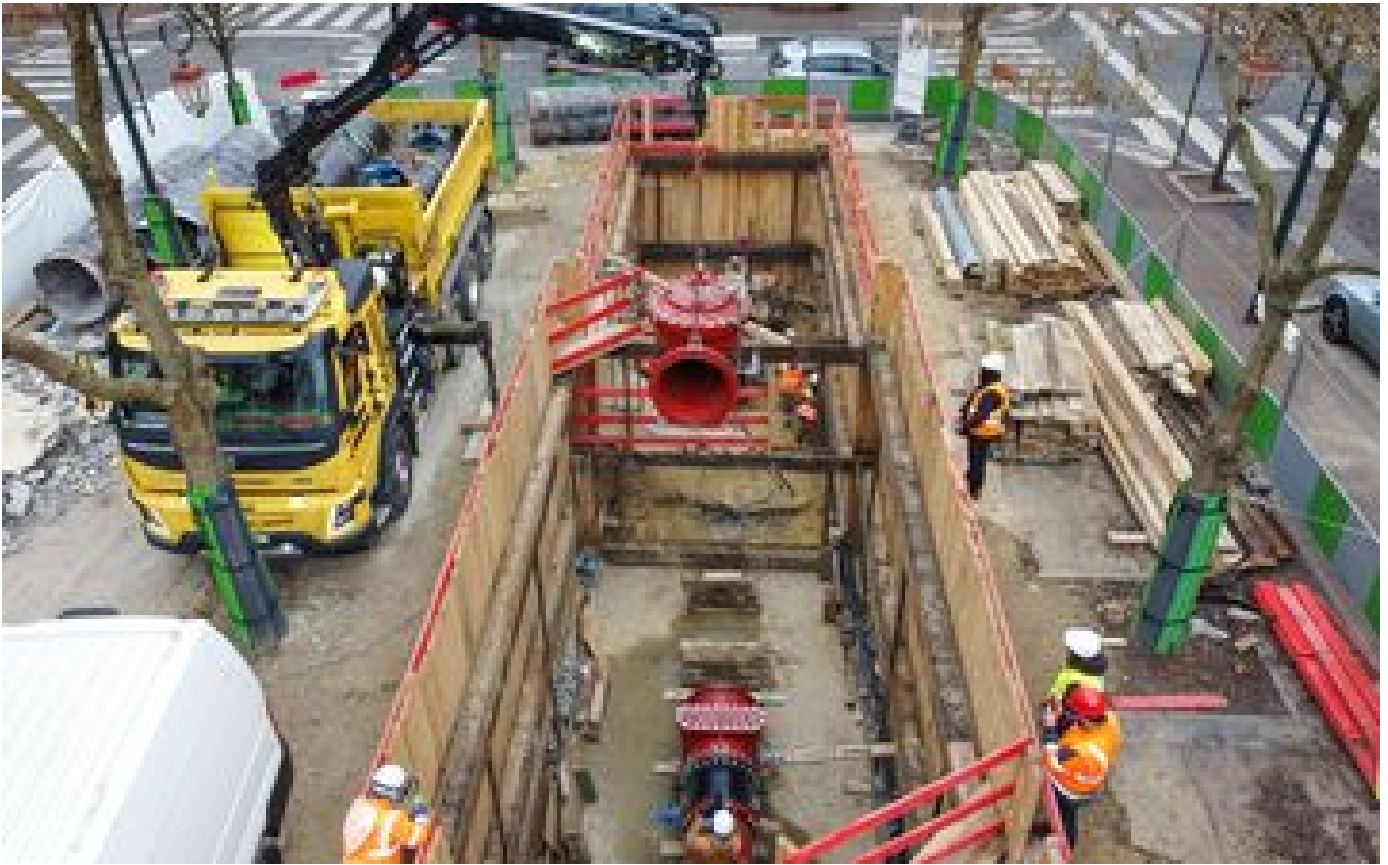
Grâce à cette vanne, les fuites sur le réseau d'eau de Clichy et Levallois vont être réduites P
