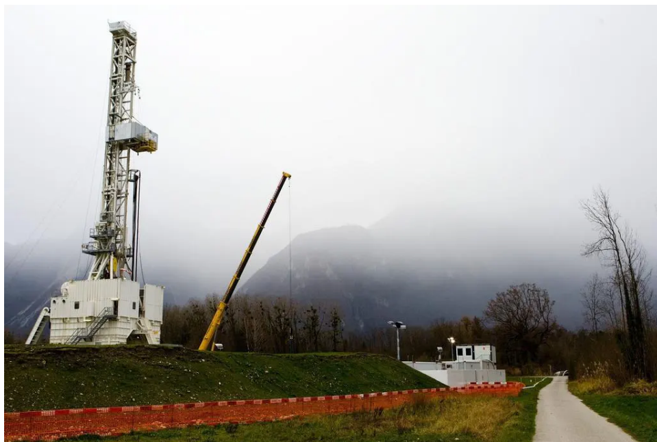
Une installation de Gaznat à Noville, le jeudi 10 décembre 2009.
