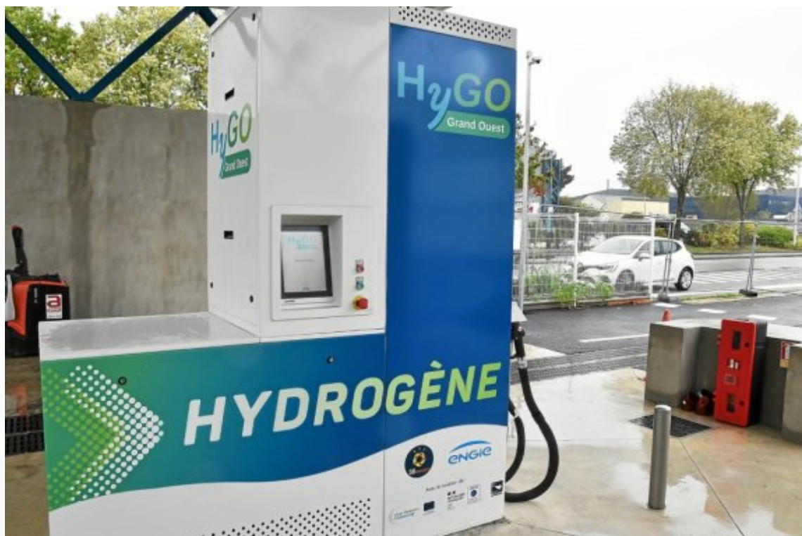
La station qui s'apprête, à partir de fin octobre, à distribuer de l'hydrogène pour véhicule, dans la zone du Prat à Vannes. (Le Télégramme/Bruno Salaün)
