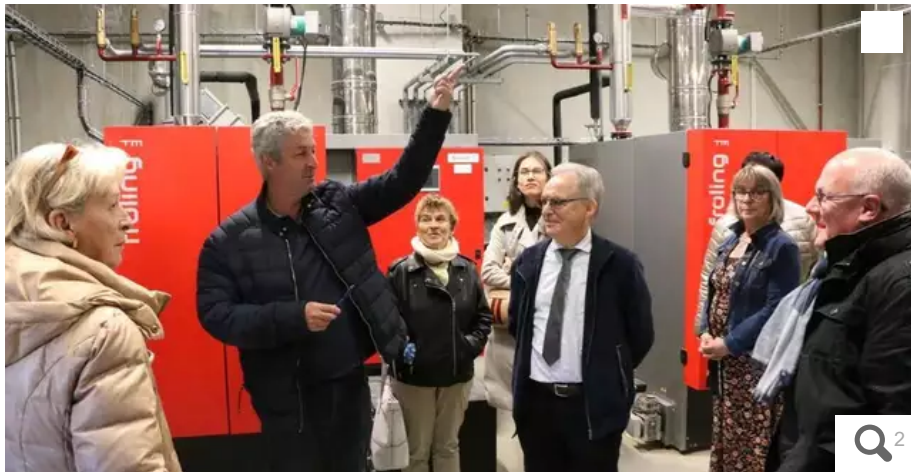
La journée de programmation de Lorient Habitat, ce jeudi 6 octobre 2022, a notamment conduit les visiteurs à la nouvelle chaufferie bois et gaz de Kervénanec qui est actuellement en phase de test. © Ouest-France
