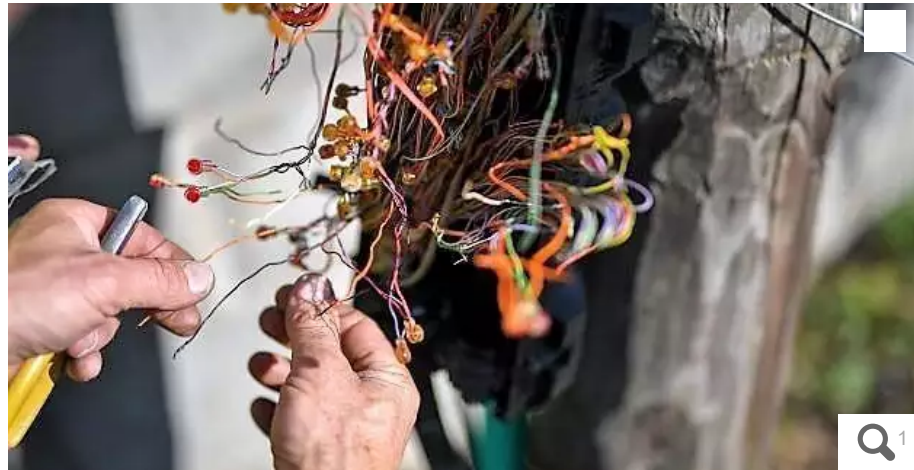
Depuis le début de l'année, Orange déplore que 8 600 mètres de câbles téléphoniques aient été volés. © Orange
