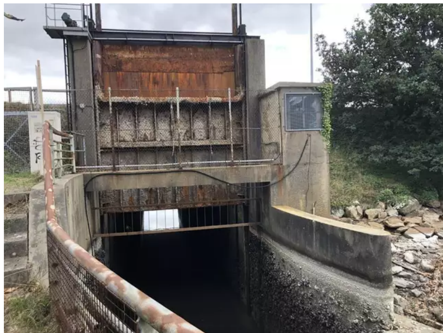
À la suite d'un incident technique, la vanne de Kermélo est bloquée en position haute, empêchant la fermeture de l'étang et le maintien du niveau d'eau. © Ouest-France
