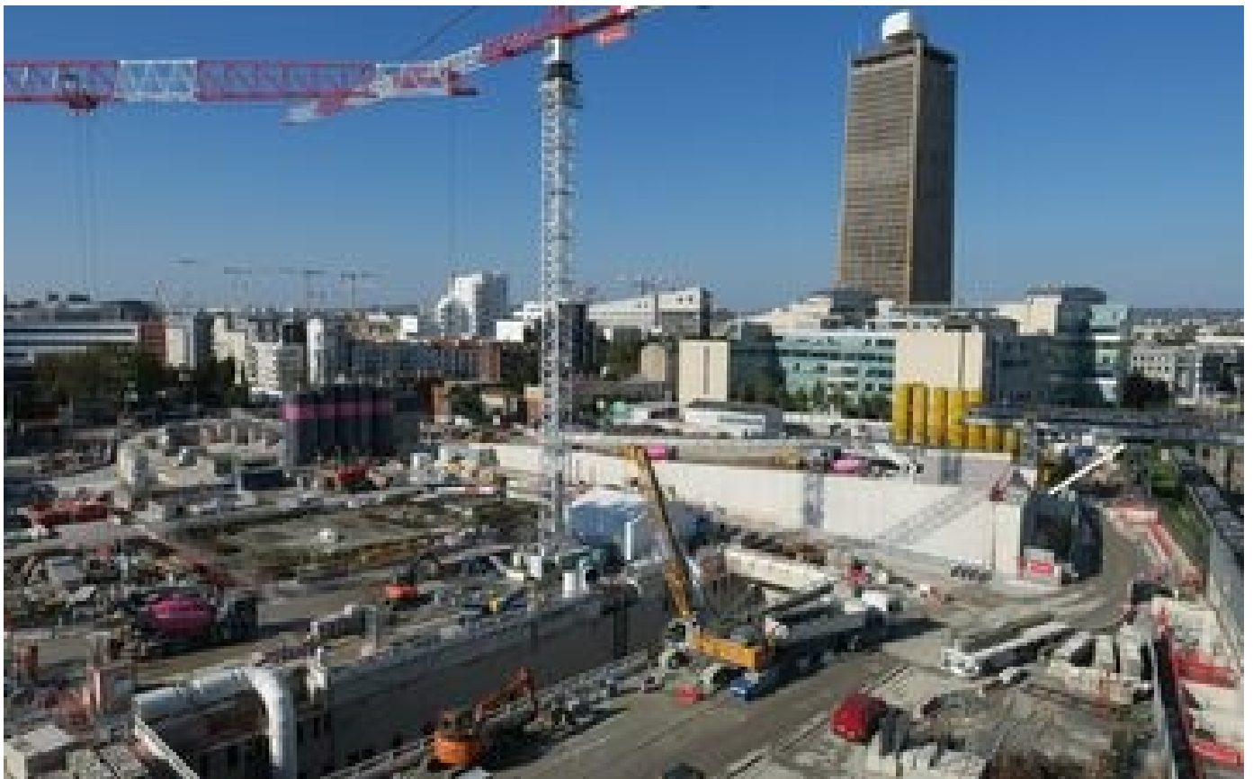
Un ouvrier meurt sur le chantier de la future gare Saint-Denis - Pleyel du Grand Paris Express
