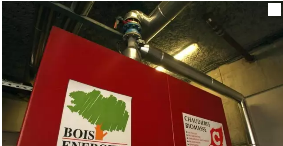
La première chaufferie biomasse de Plœmeur devrait être livrée à l'été 2022. © Archives Thierry Creux
