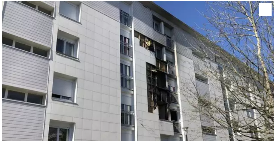
L'incendie a ravagé un appartement du 1er étage d'une barre d'immeuble de la rue Urbain-Le Verrier, à Nantes. © Ouest-France
